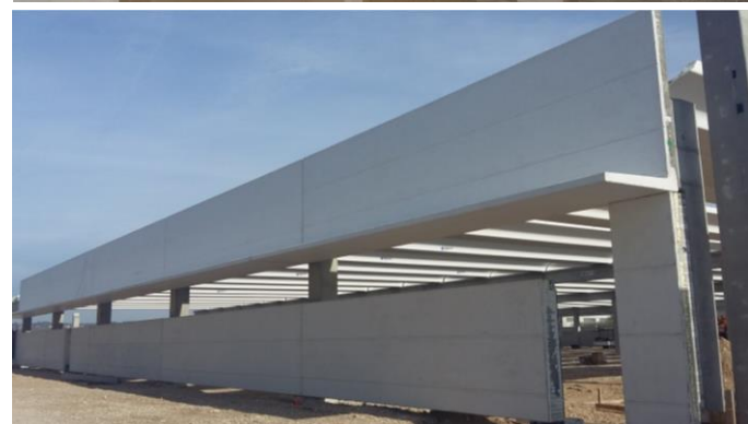
Figure 6. Mounting phases of the shelter and of the porch area inside the manufacturing building. / Fasi di montaggio della pensilina e della zona del portico interno all'edificio produttivo.
