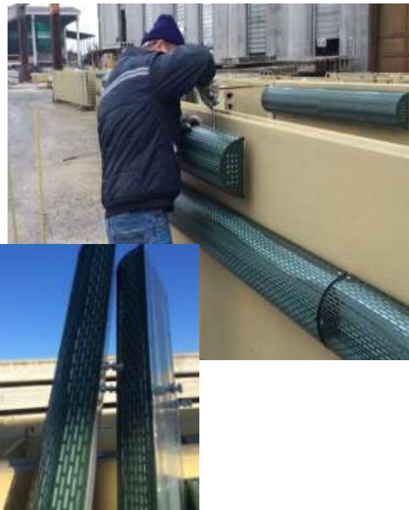
Figure 24. Sound absorbers positioning Installazione degli assorbitori
