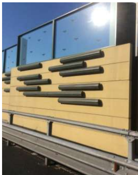
Figure 28. Example of installed noise barrier Esempio di barriere in opera
