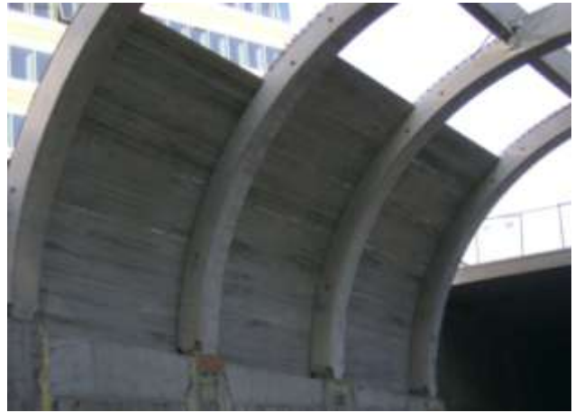
Figure 10. HC slabs in progress to realize the vault Lastre alveolari in fase di posa per realizzare la volta
