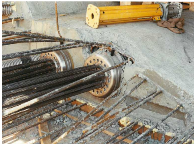
Figura 2. Rottura nella zona di ancoraggio per insufficiente compattazione del cls.
