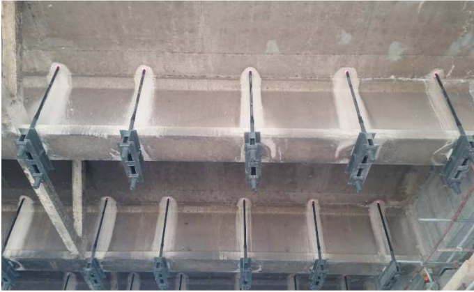
Figura 11. Tiranti a barre per il rinforzo a taglio di un ponte con travi a T
