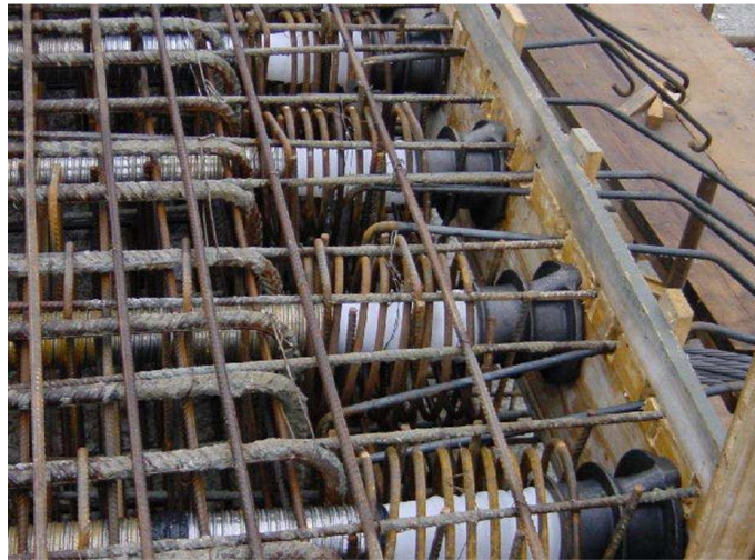
Figura 1. Spirali posizionate in modo errato (non direttamente dietro la più esterna superficie portante dell'ancoraggio)
